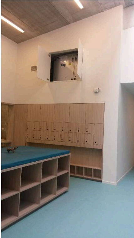
Kinderdagverblijf: luchtgroep in zolderruimte
