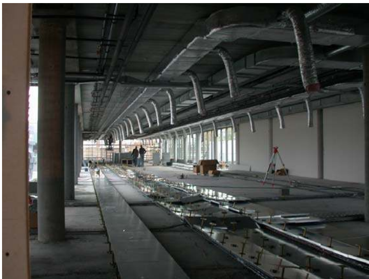
Technieken in computervloer en in plafond
