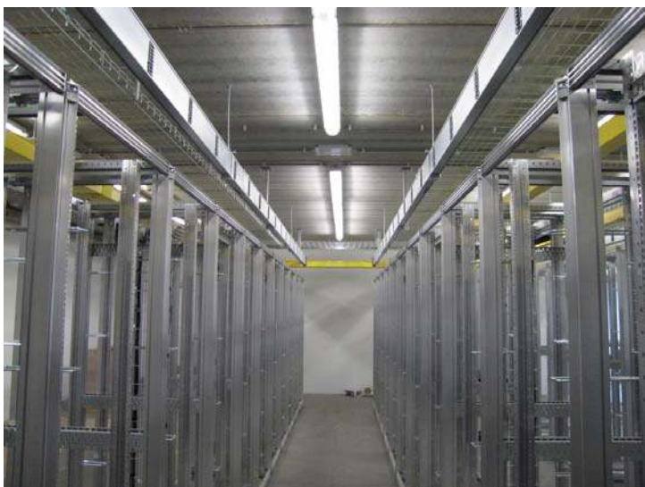
Serverruimte in labo
