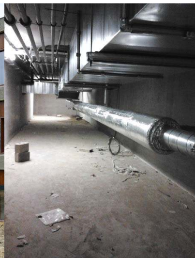
Technische ruimte kelder
