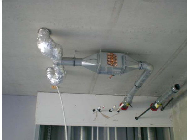
Naverwarmingsbatterij op pulsiekanaal kamers – Pulsiekanaal aangesloten op ingestort kanaal in vloer
